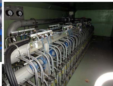
← スイッチヤード 機器は健全。 換気により 湿度も低下。
