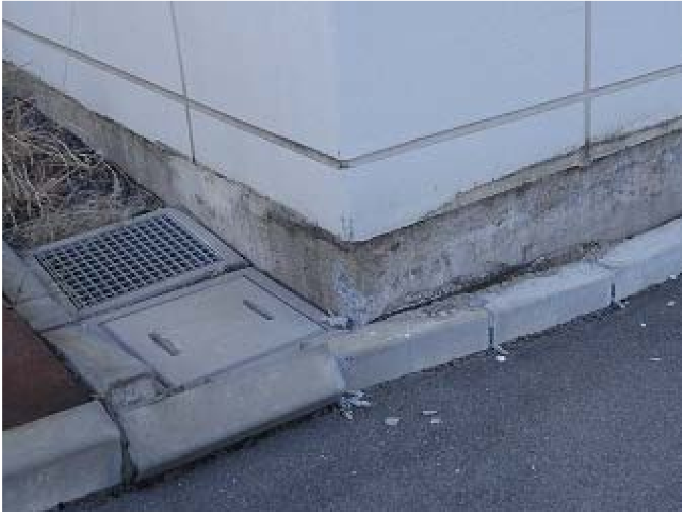
周辺部が約30cm陥没。
