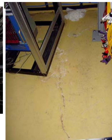
実験ホール床面にクラック 少量の漏水有り。
