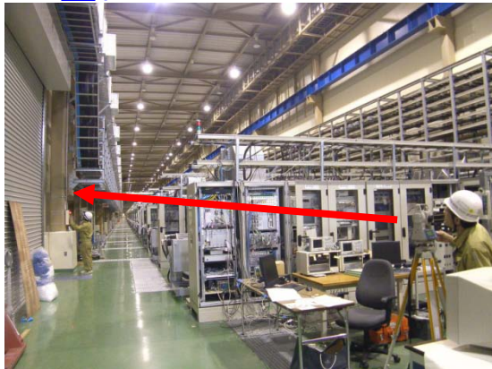
レーザーによるクライストロンギャラリーの測定（西側に10mrad程度の傾きがある）
