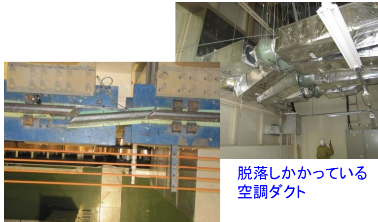
クライストロンギャラリーのクレーンレール（一部脱落）
